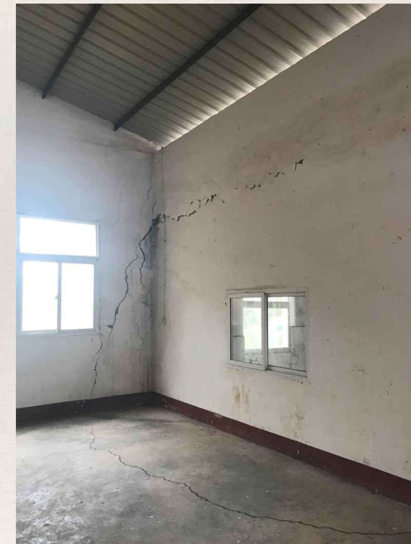
工房大埤內牆體及地面斷裂部分
